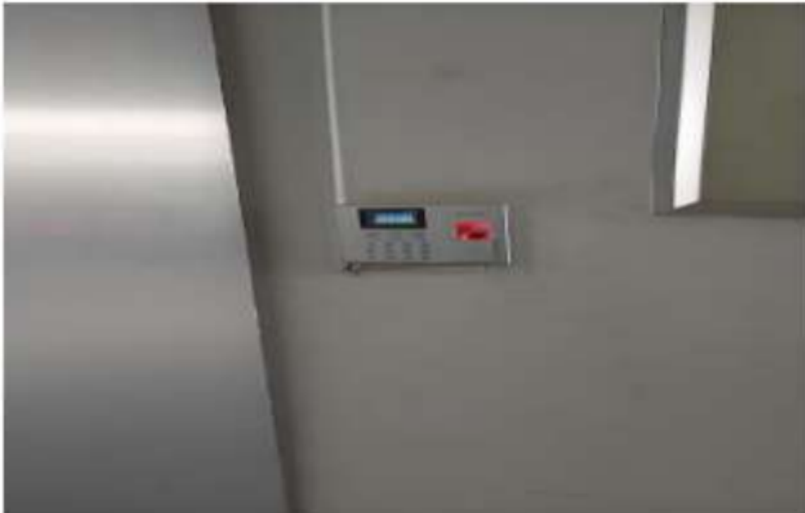
Ilustración 11 Control de Acceso al área de custodia de archivos
